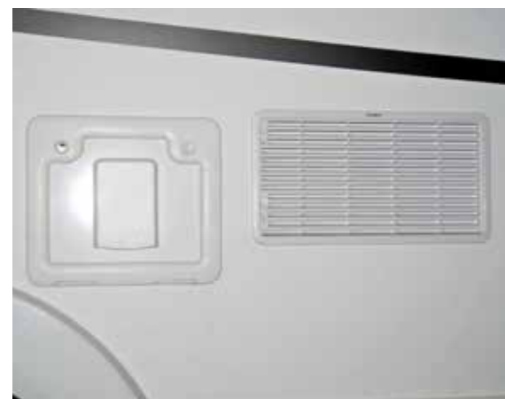
■ Unschön: Lüftungsgitter und Cassettenklappe haben unterschiedliche Höhen.
